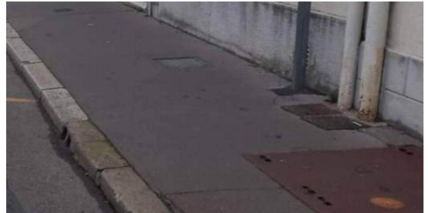
Figure 55 : Photo de deux gargouilles sous trottoir rue Chanzy – Source : ENDURANCE
